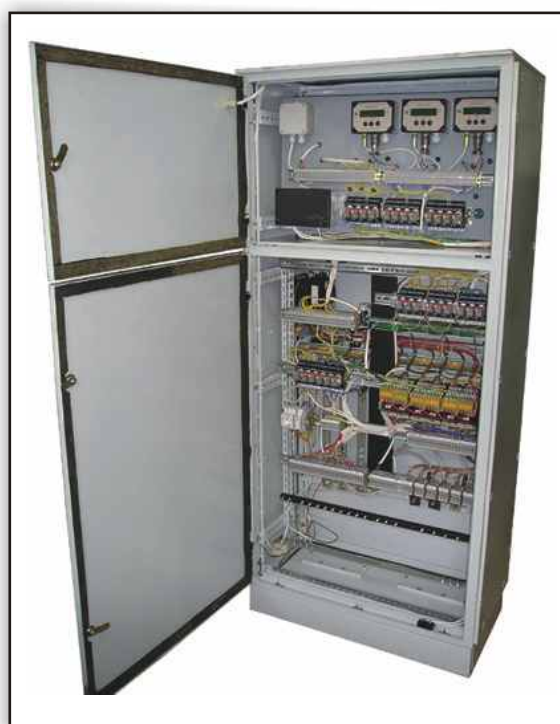
КТУ-2 в составе шкафа электроавтоматики
